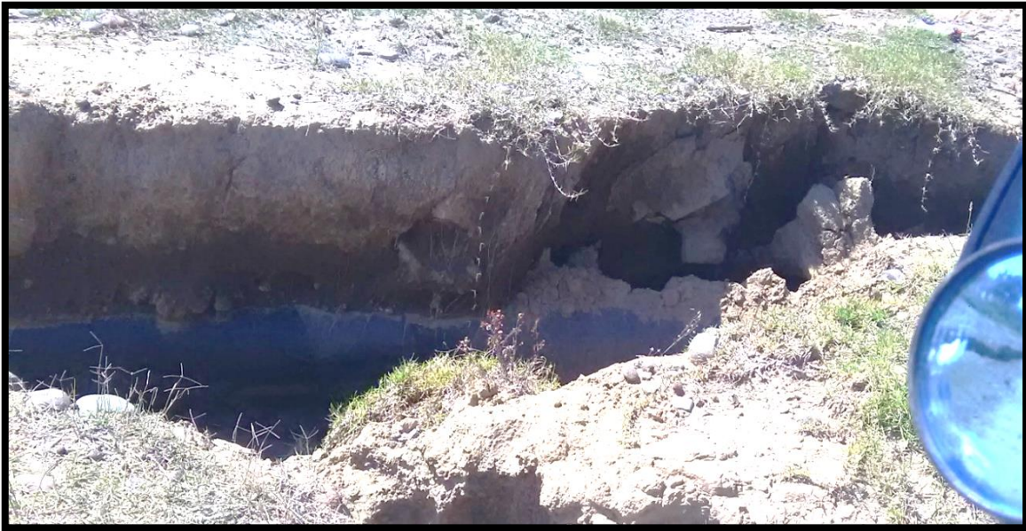
Figura 9. Ducto sobre camino de terracería Tláloc-Las Dalias
